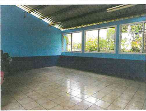
Foto 2: Sustitucion de piso cerámico en mal estado en aula principal, 56 m2.
